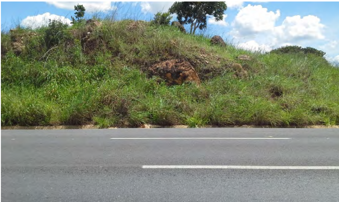
Figura R4 - 07: Exposição de blocos quartzíticos do Grupo Paranoá acumulados ao lado da BR-020 próximo a Formosa/GO.
