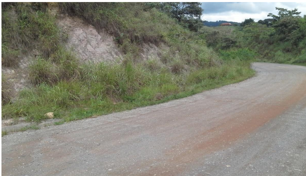
Figura R3 - 15: Calcixisto intemperizado localizado em trecho da DF-205 próximo ao núcleo urbano da FERCAL.
